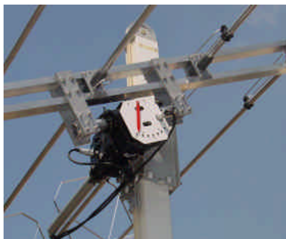
アンテナの支持部のトラックにはチルト偏波可変用ローテータが搭載
